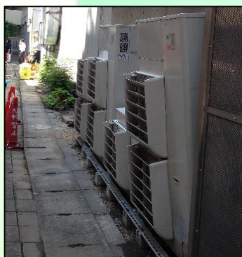
倒れそうな室外機
