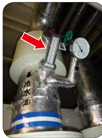
写真-D 冷水入口温度
