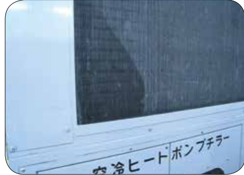
熱交換器の油のにじみ
