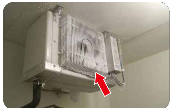
冷却器の内部霜付き異常
