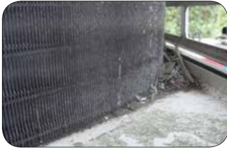
熱交換器下部の腐食
