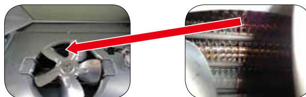
ファンの隙間から熱交換器の霜付き確認
