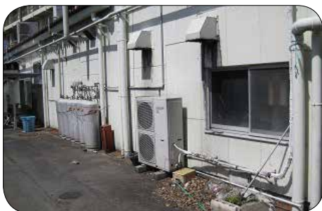
室外環境異常による配管の劣化
