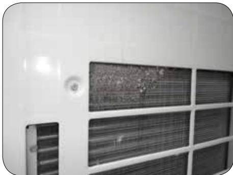
室外機に付着したゴミ
