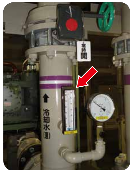
冷却水出口温度計確認
