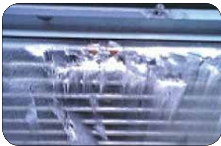
熱交換器表面の損傷
