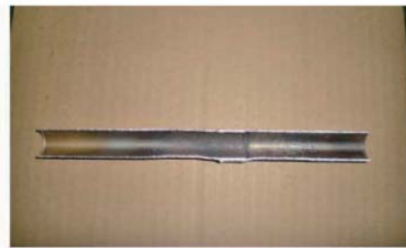
窒素ブローをしなかった場合の銅配管内部
