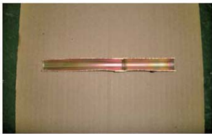
窒素ブローをした場合の銅配管内部
