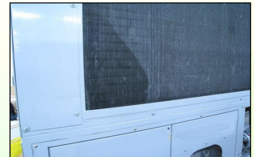
室外機の外観確認(油のにじみ)
