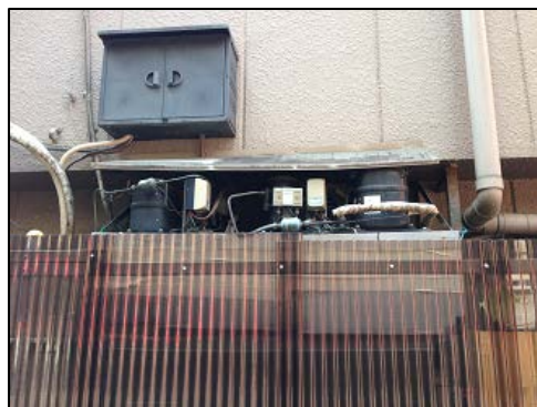
雨ざらしの室外機
