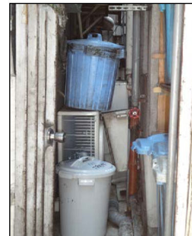
吹き出し口が塞がった室外機
