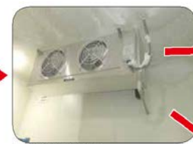
冷凍冷蔵庫の冷却器
