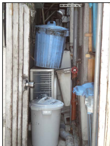
吹き出し口が塞がった室外機
