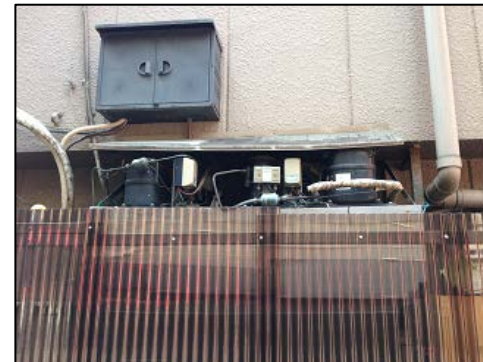
雨ざらしの室外機
