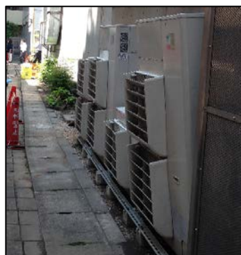
倒れそうな室外機
