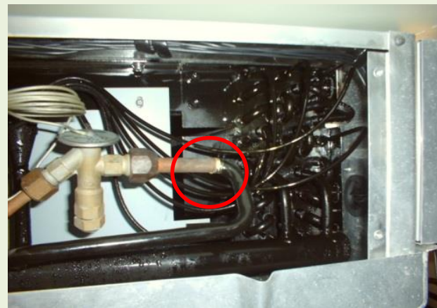
(写真)漏れ箇所
