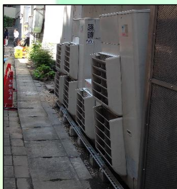
倒れそうな室外機
