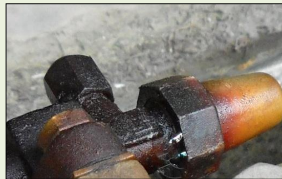
(写真)漏れ箇所
