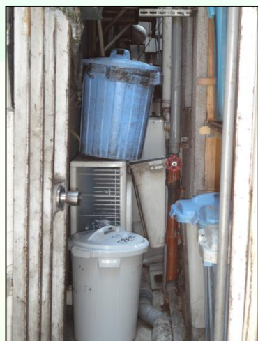
吹き出し口が塞がった室外機
