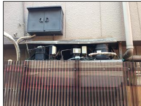
雨ざらしの室外機
