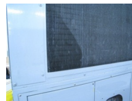
室外機の油にじみ
