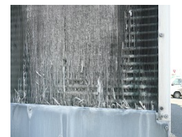
室外機の腐食
