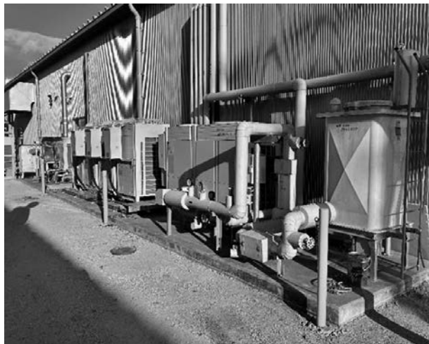
中温用AC室外機とブラインチラー設備
