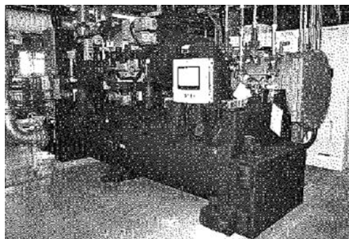
ターボ冷凍機
