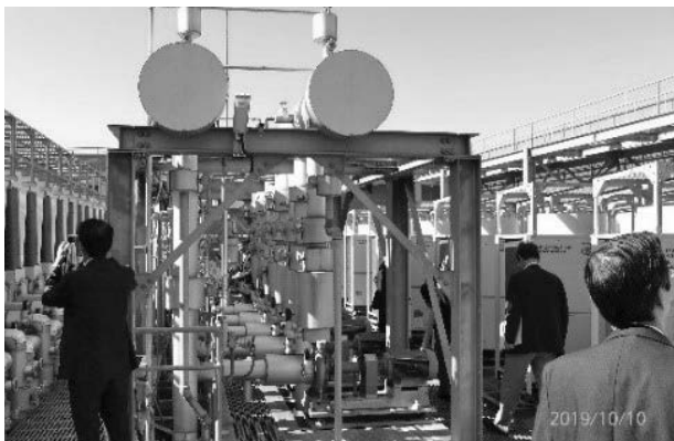
写真4 屋上設置空調熱源機
