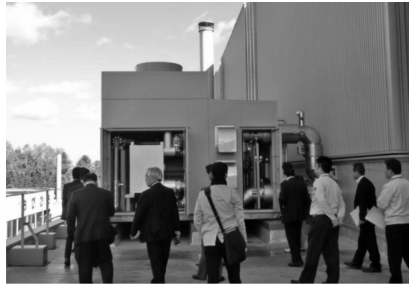
冷凍機設置状況
