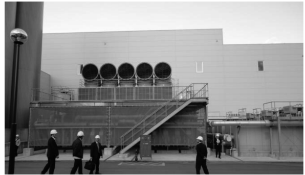
熱源設備関係全景
