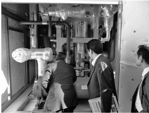
ヒートポンプ方式スクリーン冷凍機ユニット
