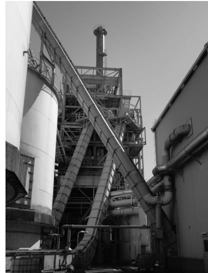
みやざきバイオマスリサイクル株式会社 巨大な発電設備
