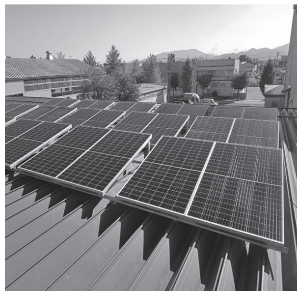
太陽光パネル
