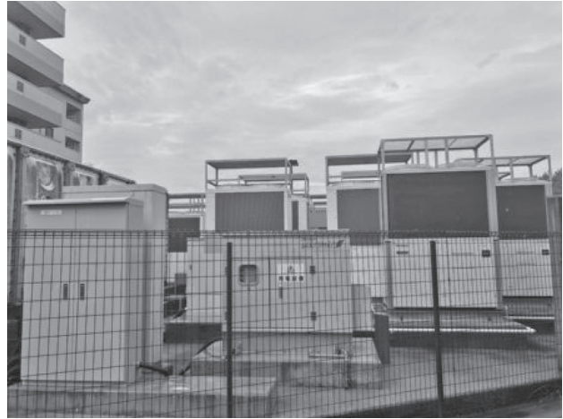
非常用発電機 外観 ハイブリッド型GHP 外観
