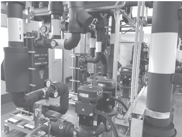
ユーティリティ冷却設備 (熱交換器および冷水 2 次ポンプ)
