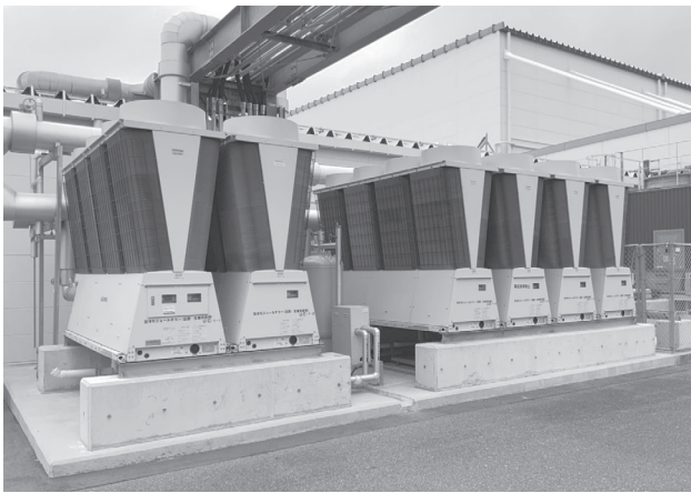
ユーティリティ冷却設備 (空冷モジュールチラー)
