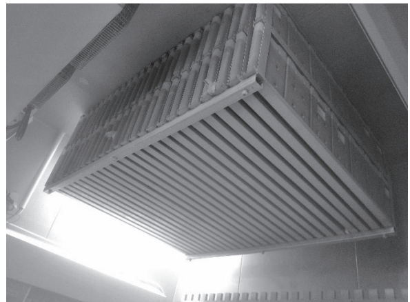
蓄熱ユニット凍結時
