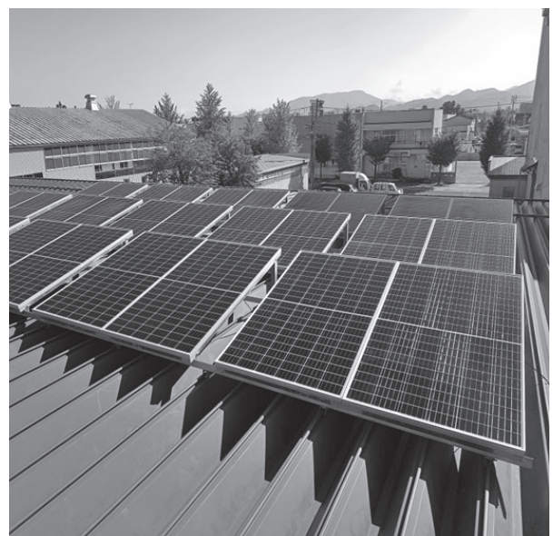
太陽光パネル
