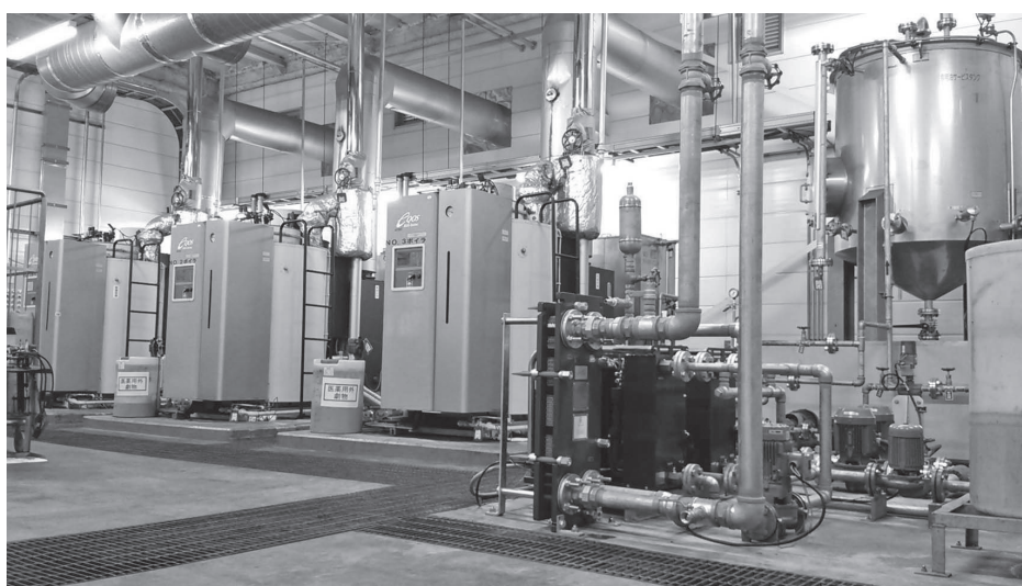
ボイラー室 給水加温
