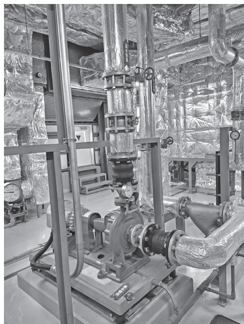
温水ポンプ廻り
