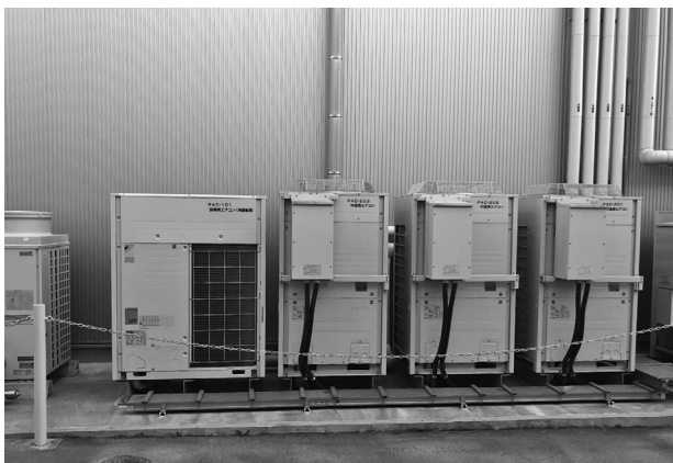
中温用エアコン室外機
