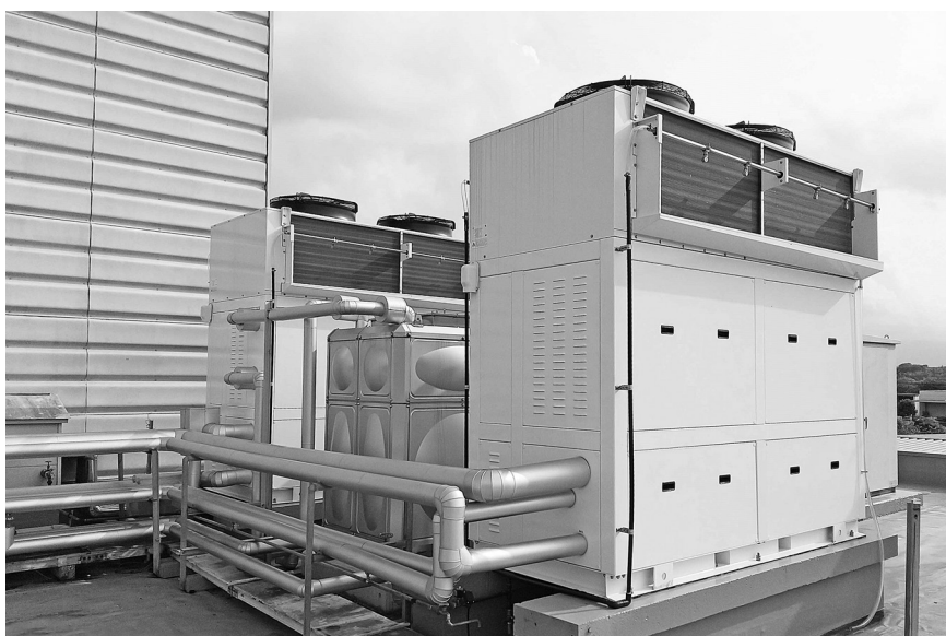
排熱回収機能付きCO 2 冷凍機とブライントーク
