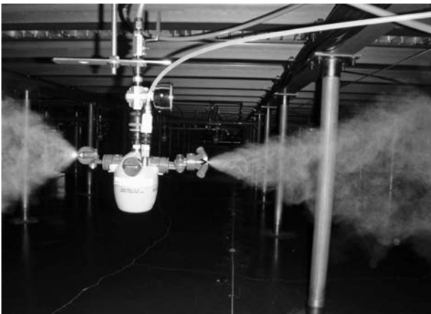
クリーンルーム床下ピットでのドライフォグ加湿状況
