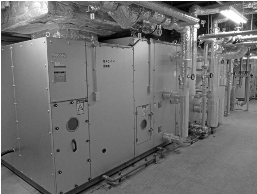
生産設備冷却水の排熱利用予熱コイルを搭載した外気処理空調機
