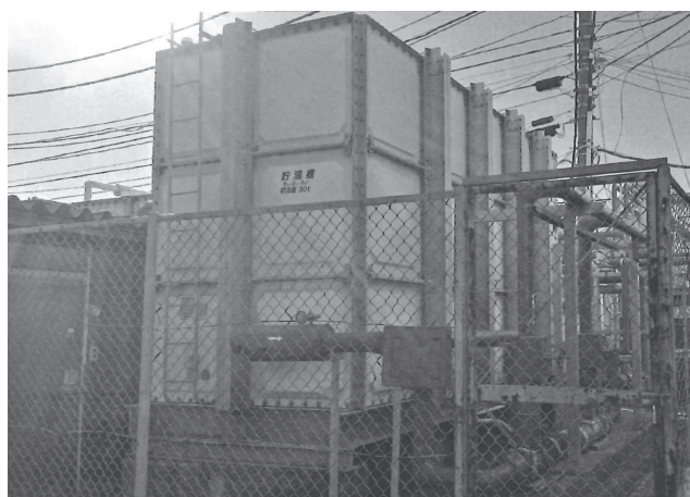
洗浄用温水タンク
