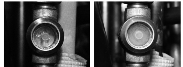
写真：冷媒漏えい時のサイトグラス （上：漏えい無し、左下：小規模漏えい、右下：大規模漏えい） ※左下は漏えいが始まったばかりだが、熟練の技術者でも目視確認では断定が難しい
