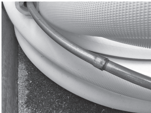
写真1 アルミ冷媒配管
