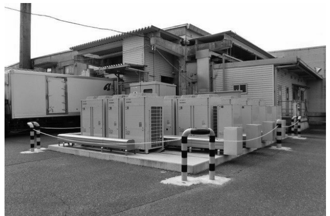
写真4 低温用エアコン室外機
