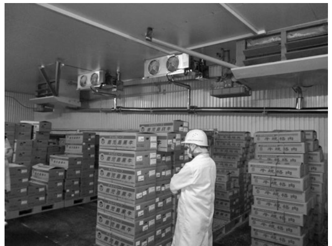
写真3 牛製品保管庫（既設機器（庫内側面）、更新機器（庫内中央））
