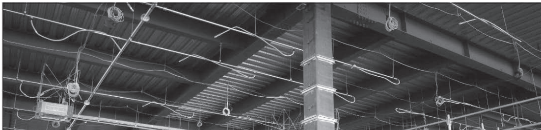
スプリンクラー配管状況
