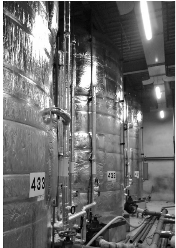
ジャケット熱交換器導入後（醗酵タンク）
