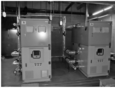
図1 排熱回収ヒートポンプ 設置状況外観
