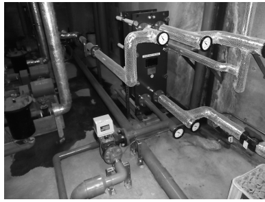
図2 排熱回収用中間熱交換器 (排湯熱回収部) * 設備業者殿施工範囲
