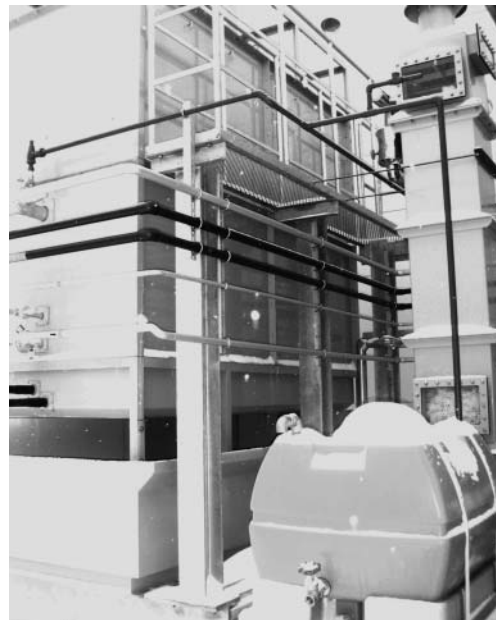
写真4 アンモニア除害設備（NH 3 スクラバー）外観
