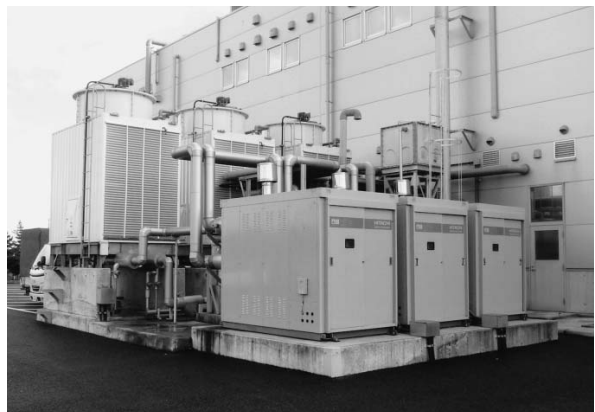
図8 吸収冷温水機と冷却塔
