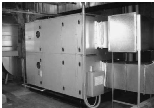
図6 熱回収ヒートポンプ外調機
