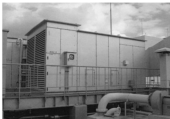
空調機（外調機）
