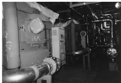
冷凍機機械室
