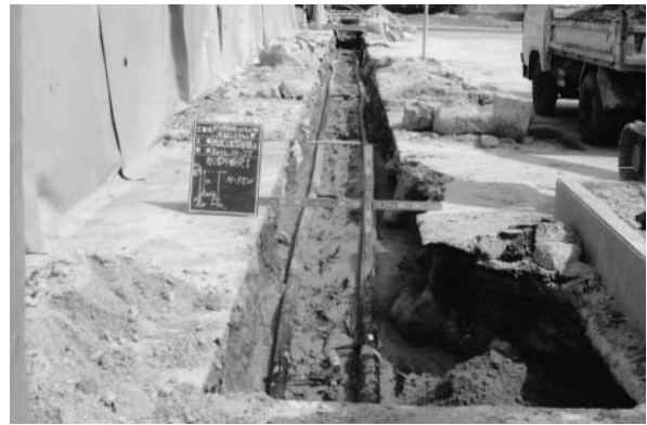
地中冷熱配管状況
