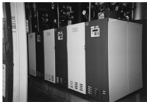
ボイラ機械室
