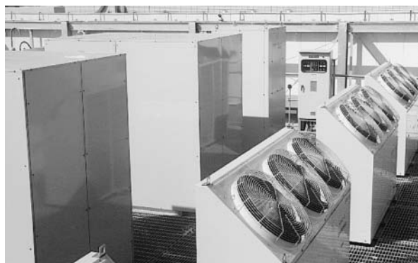
氷蓄熱槽と室外機
