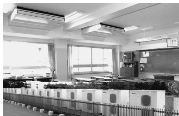
室内機と室外機
