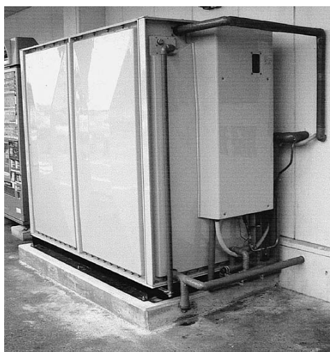
外観写真 [氷蓄熱槽]
