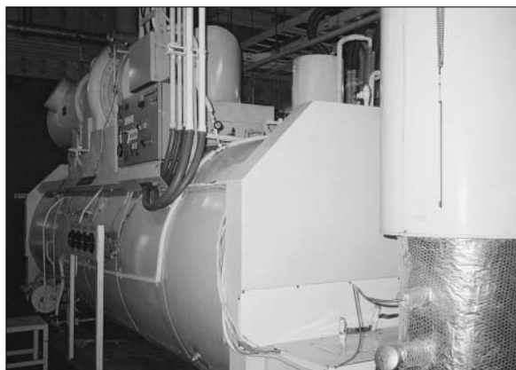
図5 ターボ冷凍機 (717RT) 外観
