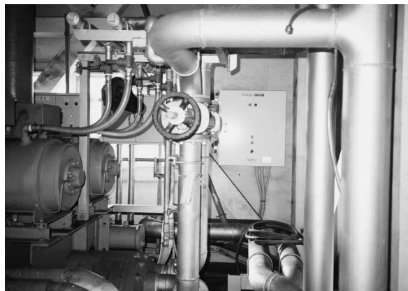
装置設置状況
