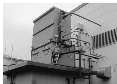
エバコンとNH 3 除外装置
