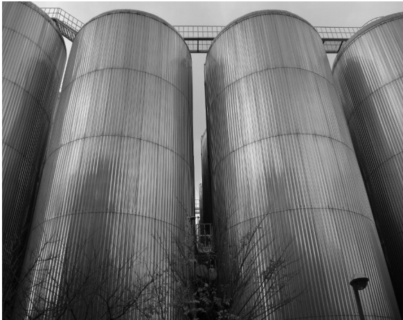
写真1 ビールタンク転用冷水蓄熱タンク
