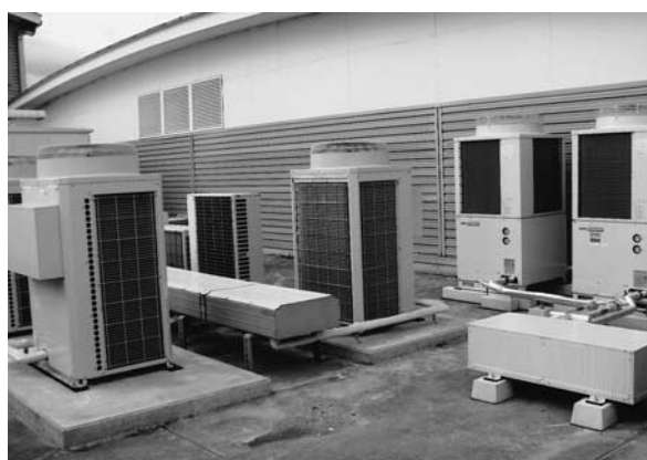
エネグリーン冷凍機と室外機
