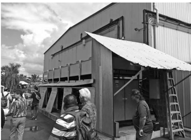
コンプレッサー8台立ての、コンデンシングユニット。台数制御により、低負荷時の省エネ運転を可能にしています。
