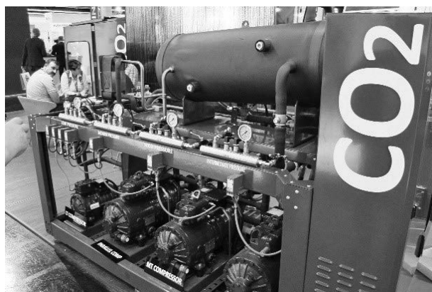
CO 2 冷凍機の例
