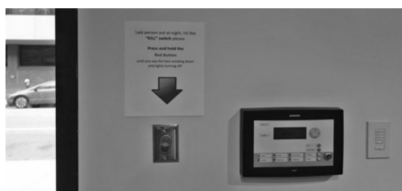
写真4 DPRビルのキル・スイッチ（上の掲示は最終退出者に対する注意事項）
