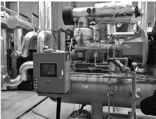
機械室内 機器類
