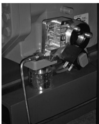
写真7 冷凍機油分配の計装品
