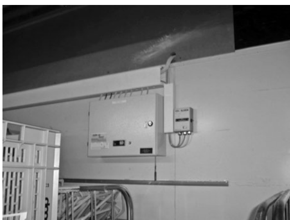
冷蔵庫制御盤とCO 2 警報装置
