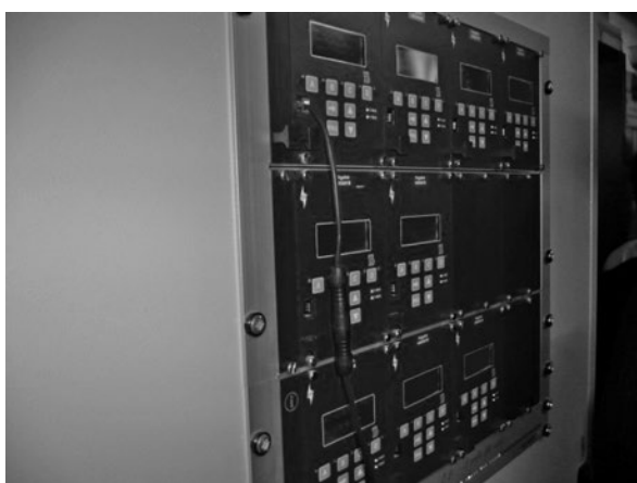
制御盤も青色
