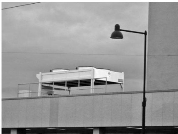
ガスクーラー：1F屋上に設置
