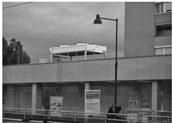
写真2 屋根の上に張り出している大型のガスクーラー
