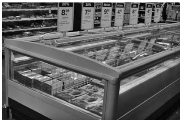
写真7 ガラス扉付きの低温平型ケース
