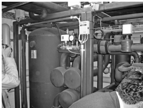
大きなレシーバタンク
