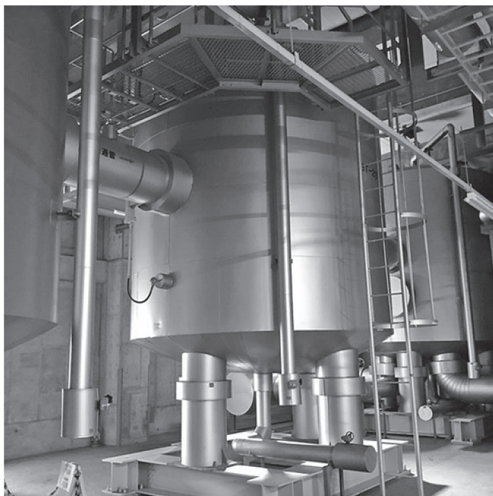
写真2 既設ブラインタンク
