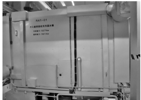
吸収冷温水機
