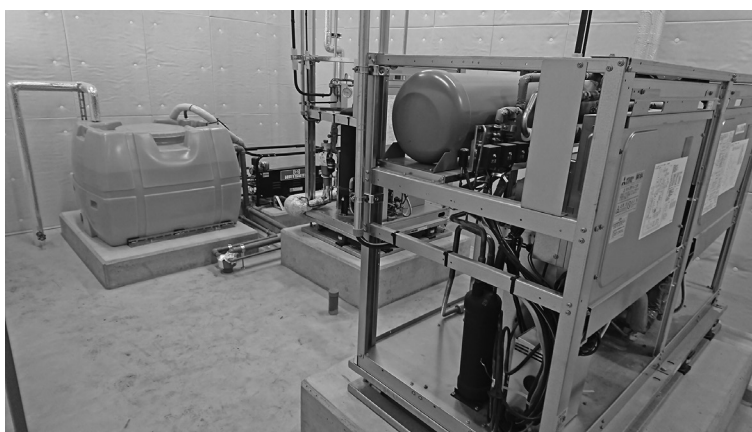
冷凍機と室内ミスト発生用タンク
