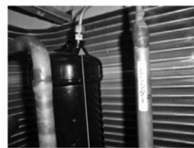
メーカーで取り出し口を設置
