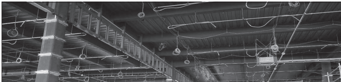
スプリンクラー配管状況
