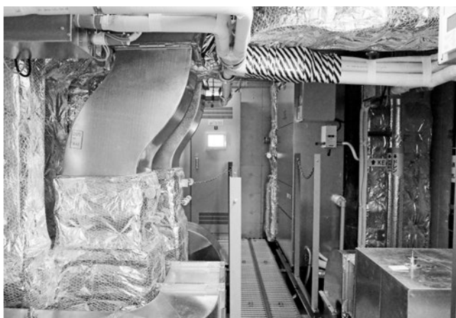
機械室内部（給気ダクト・外調機）
