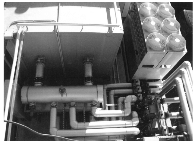
冷水管 冷水搬送用ポンプ
