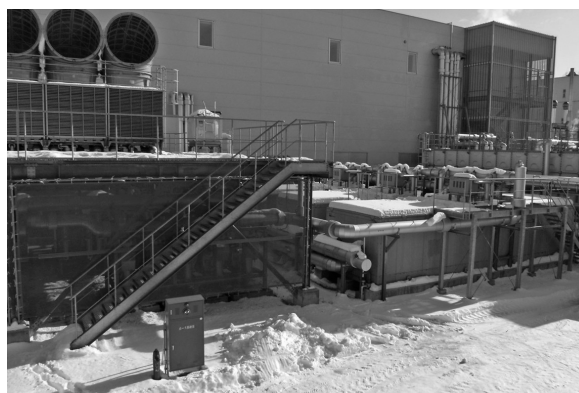
図7 熱源設備全体写真
