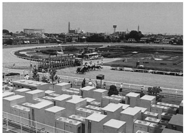
屋外設置の氷蓄熱型ユニット群
