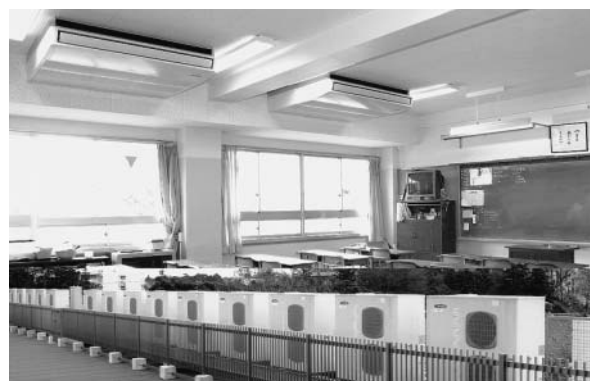
室内機と室外機
