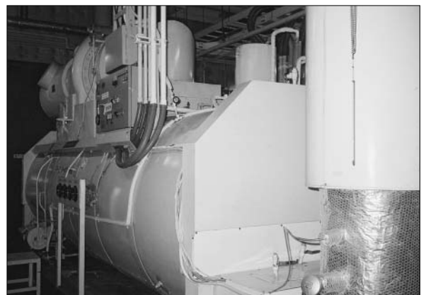
図5 ターボ冷凍機（717RT）外観
