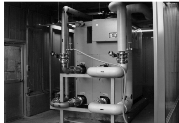
温水ヒートポンプ
