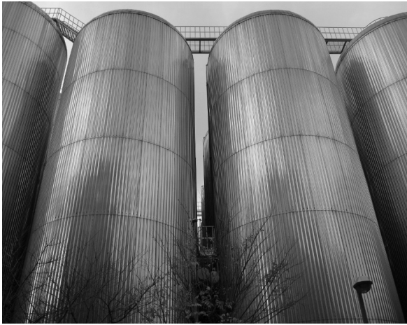
写真1 ビールタンク転用冷水蓄熱タンク
