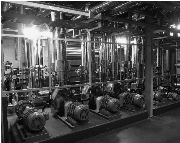
写真3 新熱回収システム及び冷水製造システム
