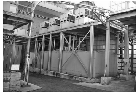
写真3 蓄熱アイスチラーおよび冷凍機設置状況
