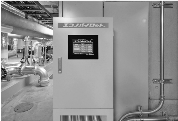
写真3 冷温水2次ポンプ 省エネ制御システムの制御盤外観
