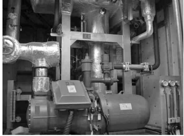
ヒートポンプユニット2台 (冷媒R134a) 加熱能力340千kcal/h/台
