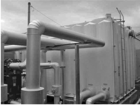
温水タンク (20ton) 2分割式 1層目温水槽40℃ 2層目温水槽37℃
