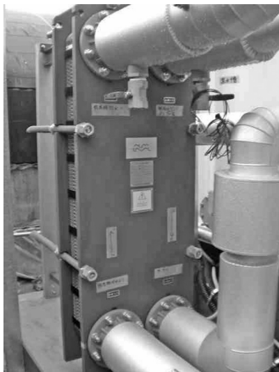
プレート式熱交換器 補給水加温
