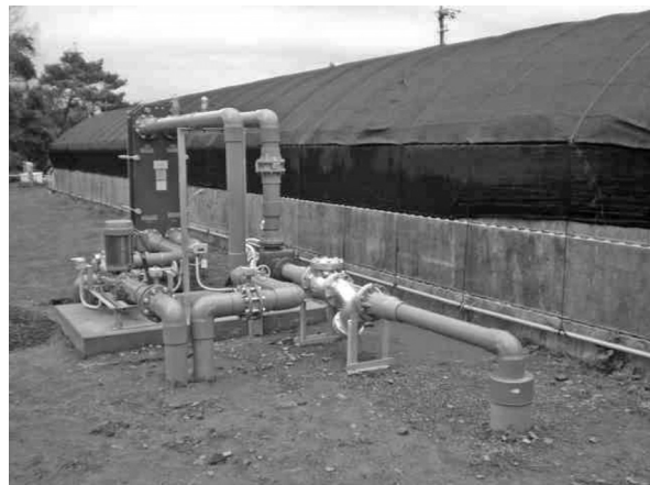
井戸ポンプ及びプレート式熱交換器 揚水量800L/min
