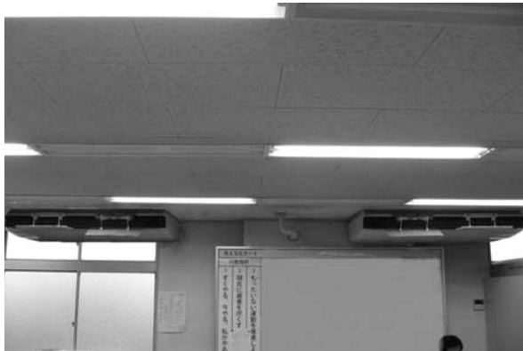
写真1 空調機移設前
